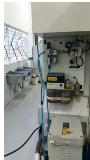
Figura 6.3.6: Detalhe maquinário e cubas
